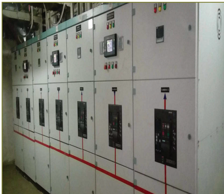
Tủ hoà đồng bộ cho máy phát Synchronizing cabinet for generator
