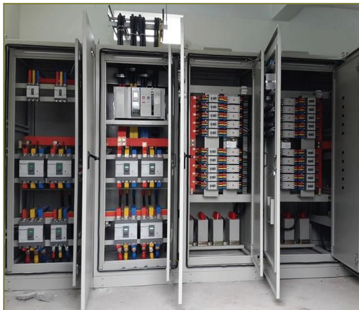
Hệ thống tủ điện phân phối Electrical distribution cabinet system
